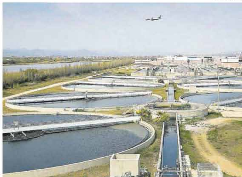
Instalaciones de la depuradora de El Prat de Llobregat.
