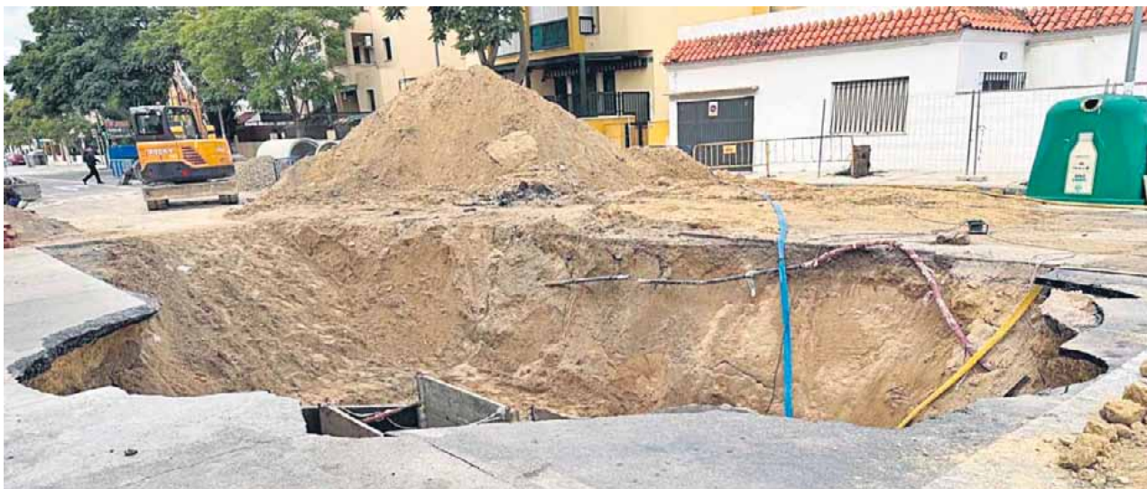
El socavón, que ha afectado a un colector de la ciudad, se ubica en la avenida de Las Piletas, en el tramo entre la Calzada de la Infanta y el Quinto Centenario.
